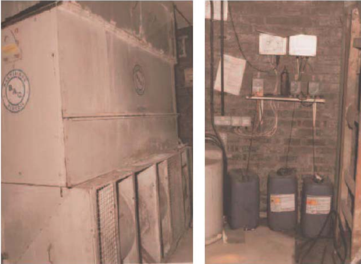
Abb. 29: Verdunstungskühlanlage ( links ) und Desinfektionsmitteldosierbehälter zur Desinfektion im Freizeitzentrum in Barrow- in- Furness 55
