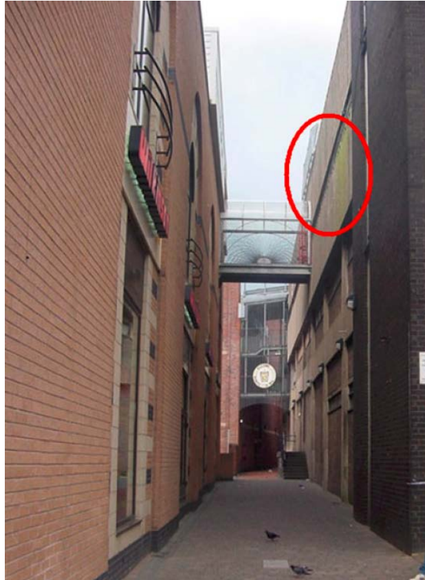
Abb. 28: Vielbegangene Verbindungsgasse, in welche das Aerosol der Verdunstungskühlanlage des Forum 28 Kunst- und Freizeit Zentrums emittiert wurde. Der Kreis zeigt die Auslassöffnung, aus dem das Legionellen- kontaminierte Aerosol kam (Copyright © Dr Nigel Calvert, NHS Dumfries & Galloway.) 19
