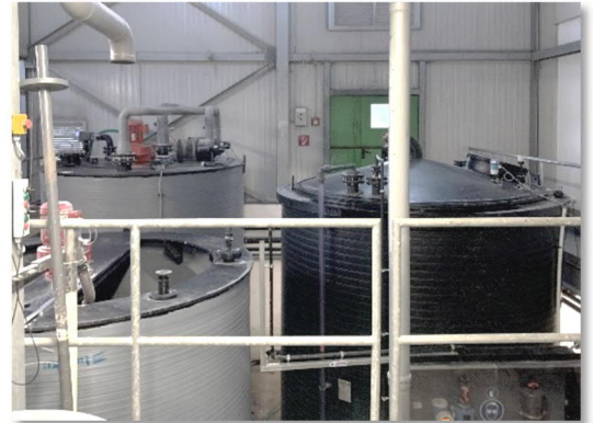
Pilotanlage Stuttgarter Verfahren. Quelle: FHNW
