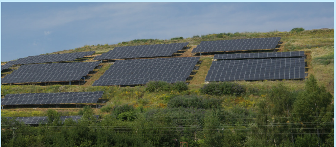
Abb. 15 PV-Anlage mit Modultischen in aufgelöster Anordnung Zentraldeponie Kornharpen (Bochum)
